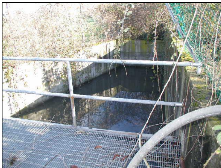
Figura 10.24 Vasca di Accumulo presso sollevamento Abbazia
