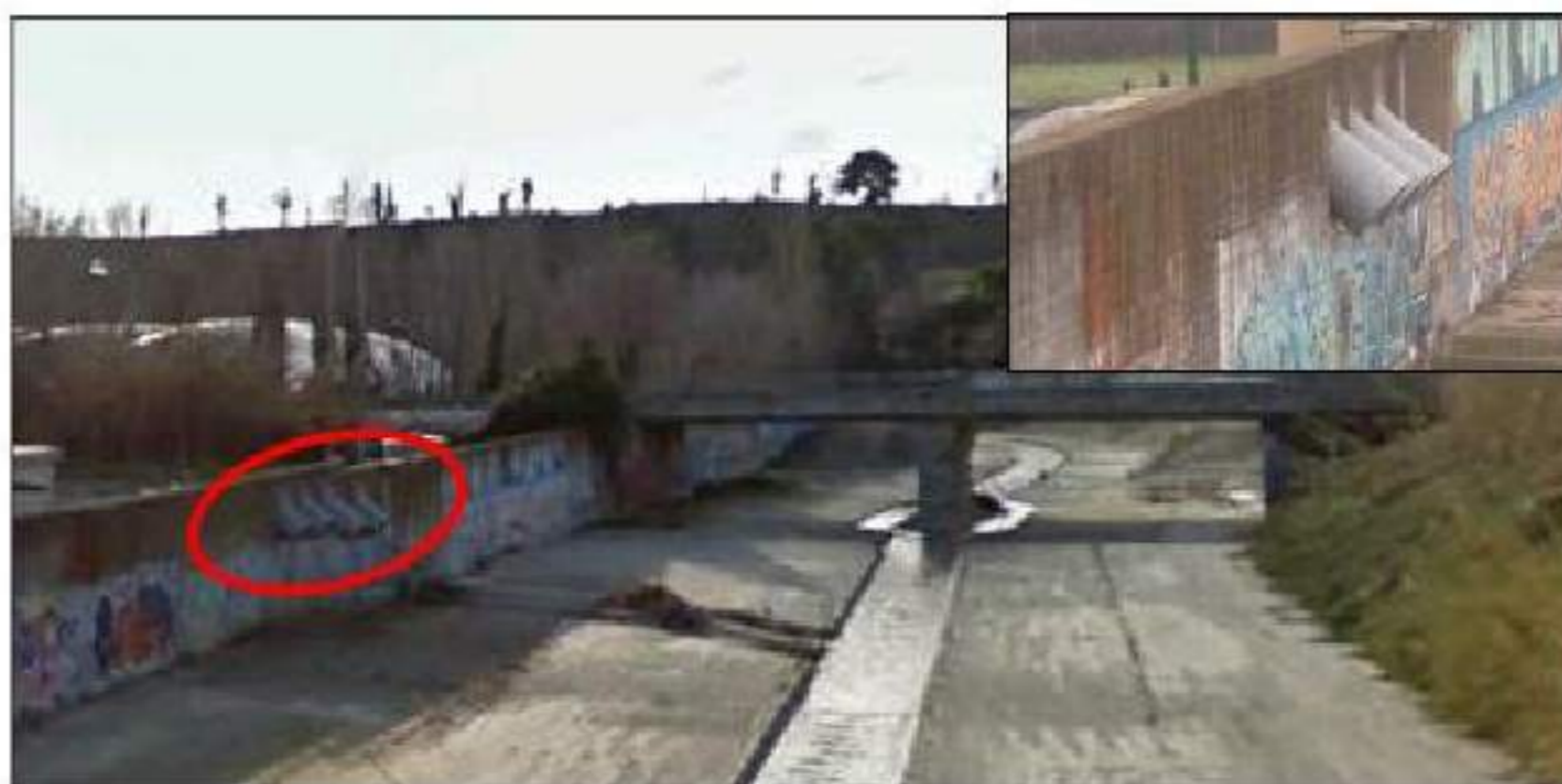
Figura 10.17. Manufatto di scarico dell'impianto idrovoro Ventena nel Torrente Ventena.
